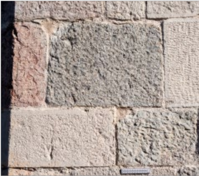
fig. 9 – Lavorazioni delle pietre utilizzate nel battistero. Le due pietre d'angolo sulla sinistra sono in Rosso Ammonitico Veronese (in alto) e Oolite di Massone (in basso), rifinite con la punta fine di una subbia e delimitate da un nastrino. I due blocchi adiacenti sono di Oolite di San Vigilio e sono lavorati con una subbia a punta grossa (o eventualmente anche con un piccone da scalpellino) senza ulteriore rifinitura e senza nastrino ("apparecchio rustico" secondo la definizione di Pegoretti). Il blocco parzialmente visibile in alto a destra, recante tracce di uno strumento a lama dentata, è pertinente ai restauri degli inizi del Novecento.
