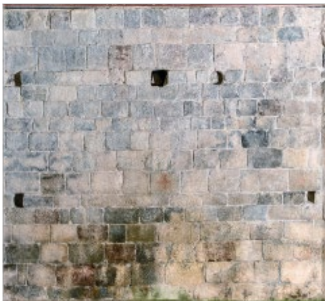
fig. 6 – Paramento interno della parete nord del battistero. La tecnica costruttiva in blocchetti è regolare con filari orizzontali e limiti delle bancate definiti dai filari di spessore inferiore corrispondenti alle buche puntaie (foto ed elaborazione di Martina Andreoli e Paolo Chistè, Università di Trento).
